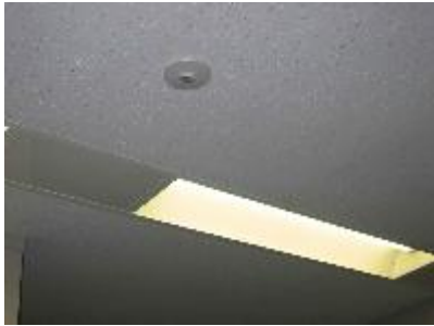
(1) 設置された人感センサー(天井の丸い機器)
